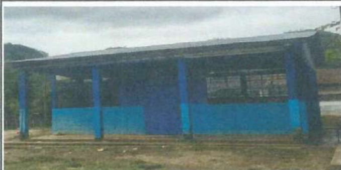
Foto 1: Se observa que la pintura de la escuela se encuentra en mal estado, presentando desgaste, decoloración y desprendimientos.
