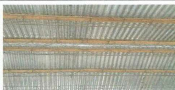
Foto 2: Se identifica el mal estado de la estructura del techo, ya que el desgaste de la madera ha debilitado su resistencia, representando un riesgo para la seguridad de la comunidad educativa.
