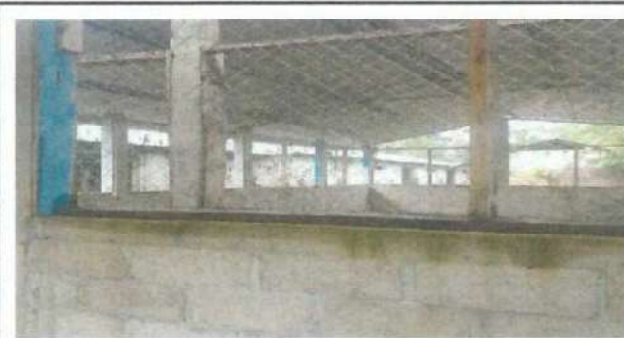
Foto 4: Se identifica que las ventanas fueron instaladas de manera improvisada y no cumplen con las condiciones adecuadas, lo que afecta la seguridad, ventilación e iluminación del espacio educativo.
